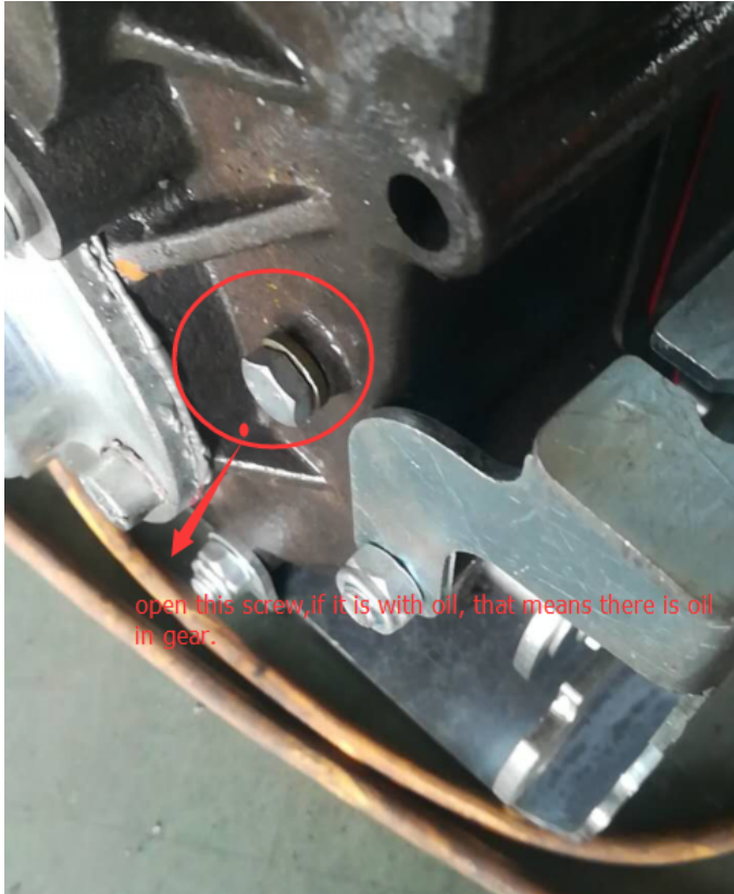
Kontrolní šroub oleje převodovky
